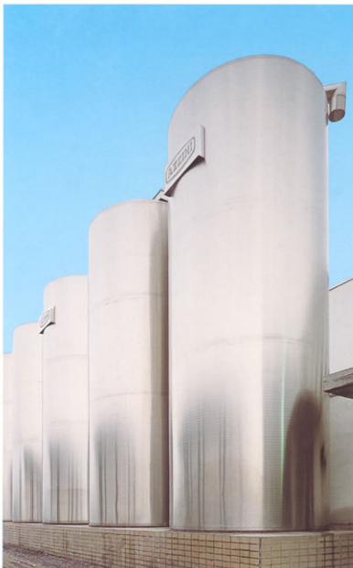
■ Serie di serbatoi termocondizionati.
