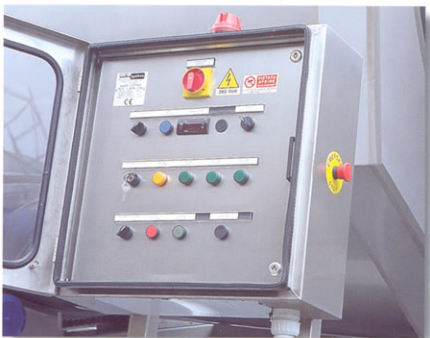
■ Quadro di comando.
